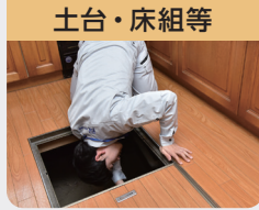
ひび割れ、劣化、蟻害等
