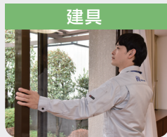
開閉不良、外壁との隙間
