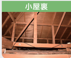
雨漏りの跡、腐朽等
