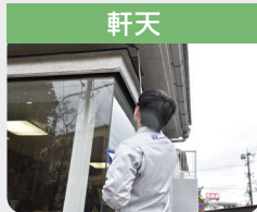
雨漏りの跡、ひび割れ
