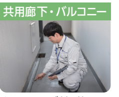
くらつき、ひび割れ等
