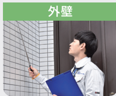
ひび割れ、浮き、劣化等 シーリング材の劣化等
