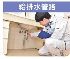
水漏れ、排水不良、滞留等
