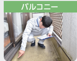
ひび割れ、劣化等
