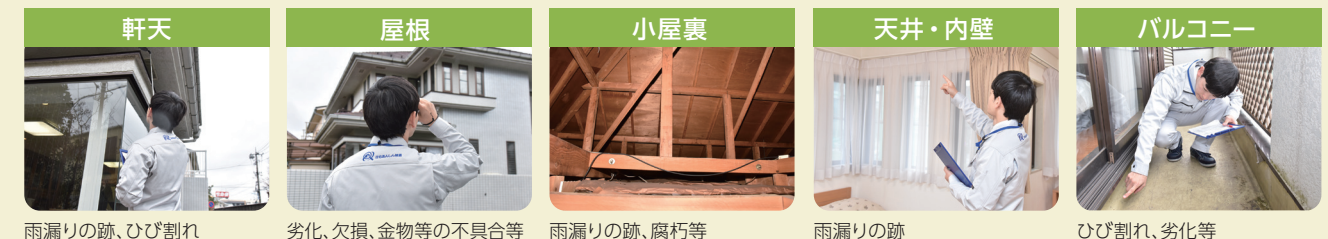
雨漏りの跡、ひび割れ
