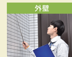
ひび割れ、浮き、劣化等 シーリング材の劣化等
