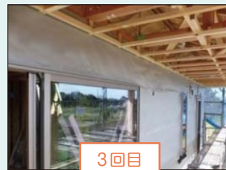
3回目 防水検査
